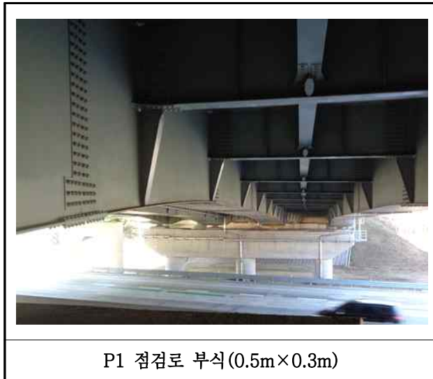
【사진 1.3.26】 교량 점검시설 손상현황
